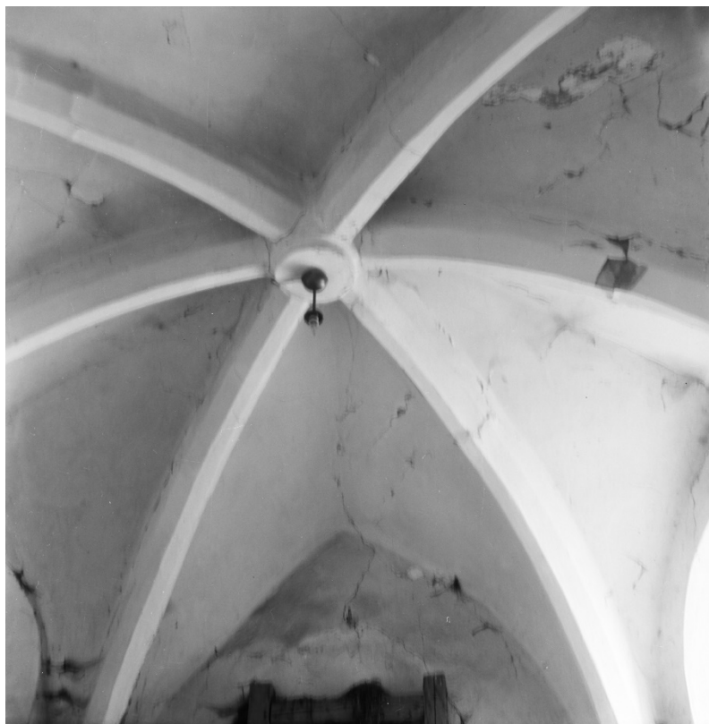
Klenba presbytáře v pohledu od západu. Foto: 1973, sbírka negativů NPÚ ÚOP v Ústí n. L., sign. 49254.
